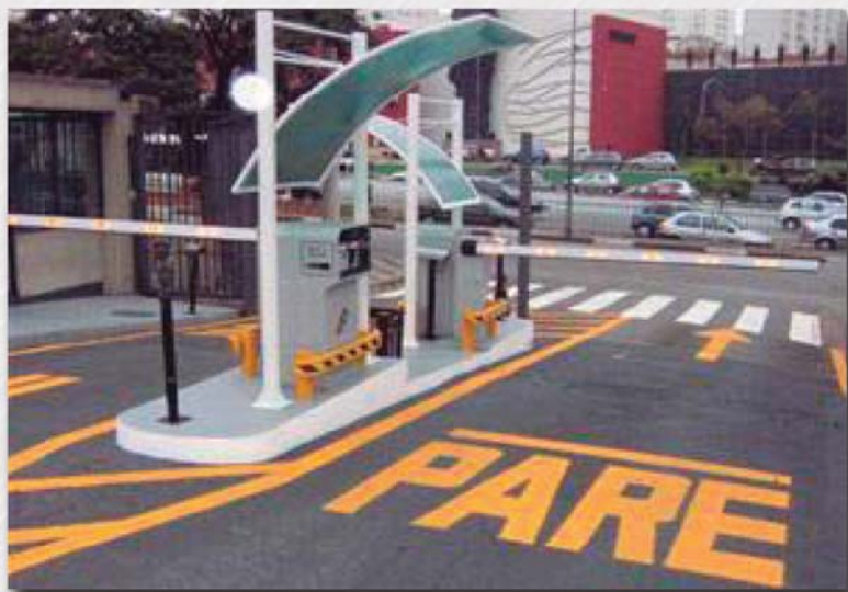
Leitores UHF posicionados para identificação nas pistas
